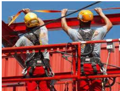
Ilustración 46 Barandillas, pasarelas y redes de protección
